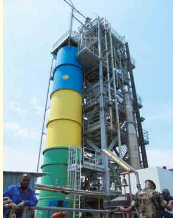
Abb. 2: Methangasförderanlage im Kivusee
